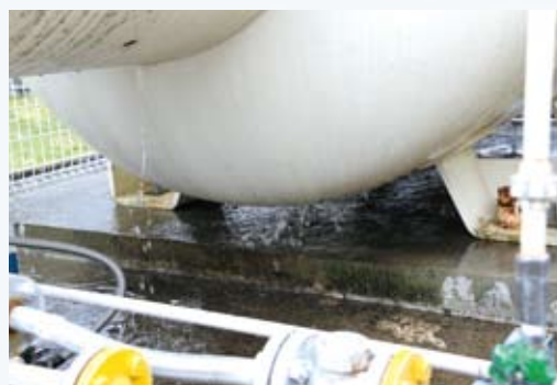
ブタンガスタンク加湿散水
